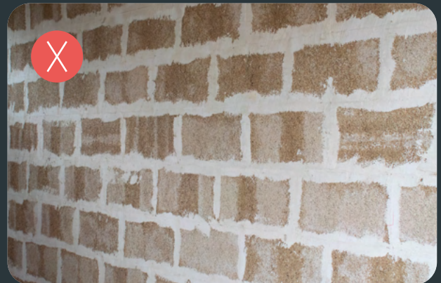
Mauvais traitement des joints
